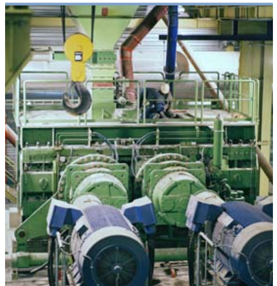
Door gebruik te maken van een energiezuinige rollenpers bespaart Gent 20% op haar totale energieverbruik.
