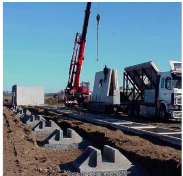
Vägg i fundament
