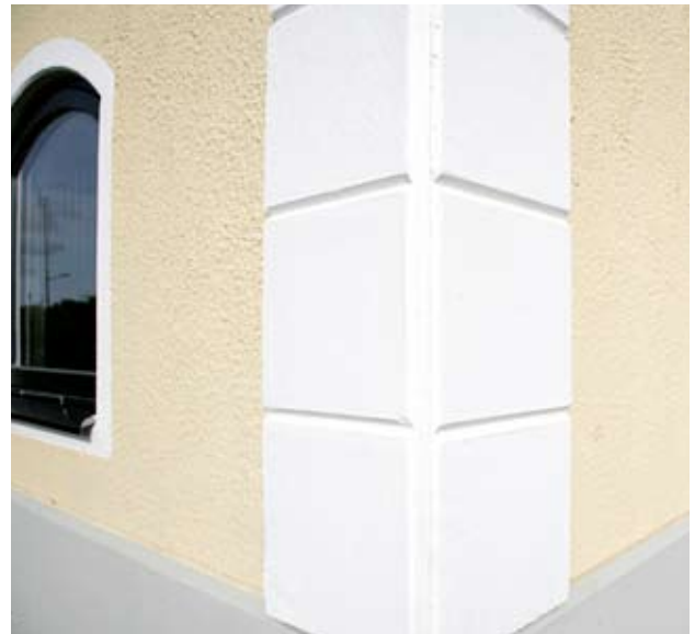
Byggnadens karaktär kan förstärkas genom att betongelementen utförs med friser, förhöjd sockel, pilastrar m.m.
