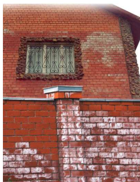
Рис. 1. Высолы на кирпичной кладке при применении портландцемента
