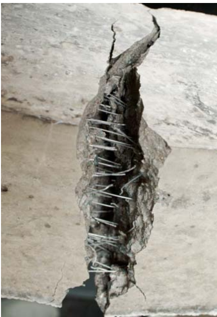
Bild 1: Gebrochener Stahlfaserbetonbalken Foto: HeidelbergCement AG
