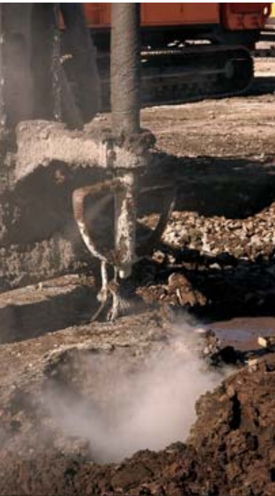
Eltebuen blåser luft på vei ned og kalksement på vei opp. Fart og rotasjon er beregnet etter hvilken holdfasthet som er ønskelig. Her er en kalksement søyle akkurat gjort ferdig.
