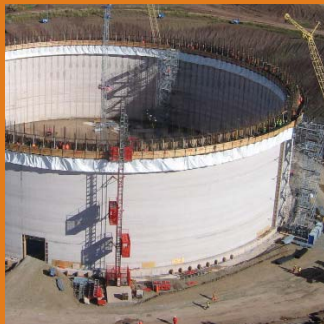
LNG tank, Milford Haven.
