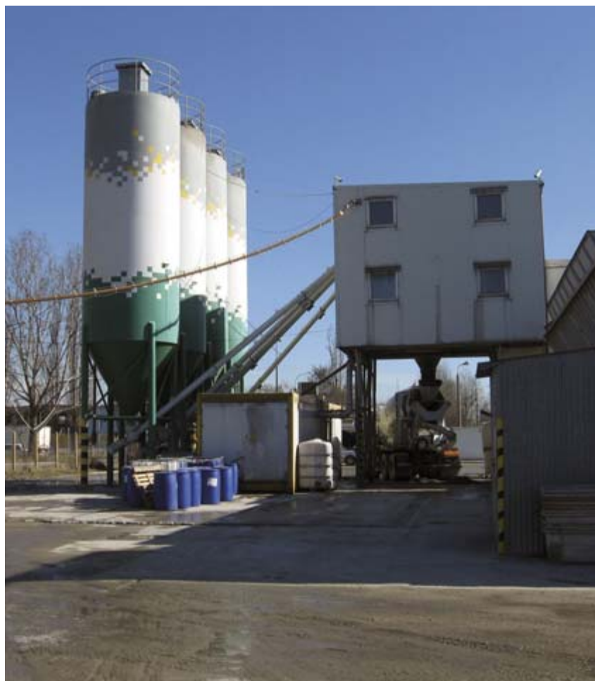
Silosy cementu i mieszalnik.
