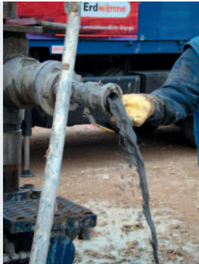
Überlauf der Mischzone Wasser/ThermoCem
