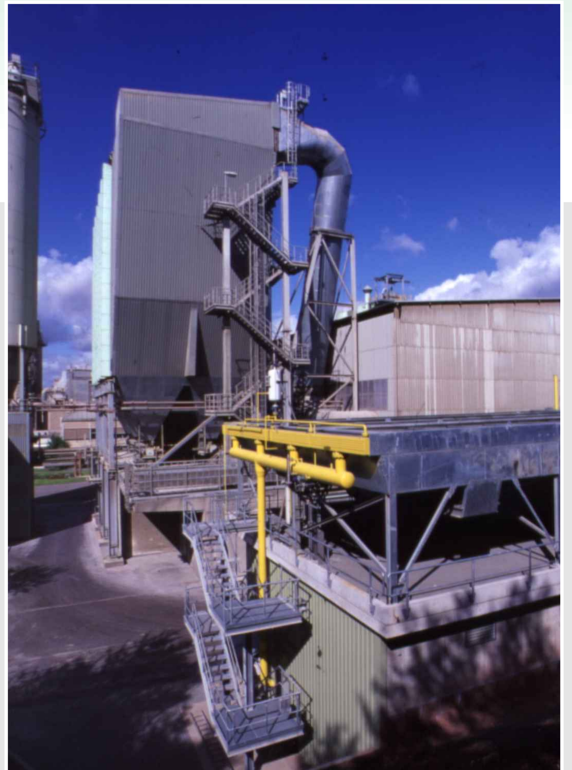
Heißfilter für Klinkerkühlerabluft mit ORC-Anlage
