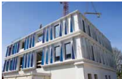
TioCem, een luchtzuiverend cement, wordt gebruikt voor de bouw van een zorgcentrum in Zwijndrecht (Nederland)
